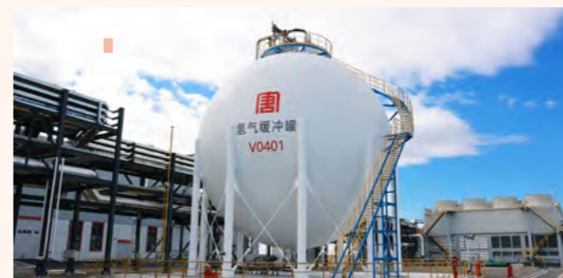
内蒙古多伦 15 万千瓦风光制氢一体化示范项目成功投运，并完成行业首个自主知识产权绿电制氢耦合煤化工能量管理平台开发
